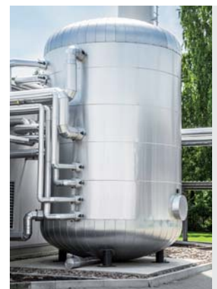
Die Abwärme der Kompressoren und Kühlhäuser wird im Wärmespeicher zwischengespeichert
