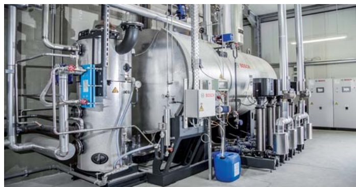
Das Wasserservicemodul mit Wärmerückgewinnung des Absalzwassers
