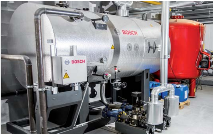
Reduzierung von Zusatzwassermengen durch das Kondensatservicemodul
